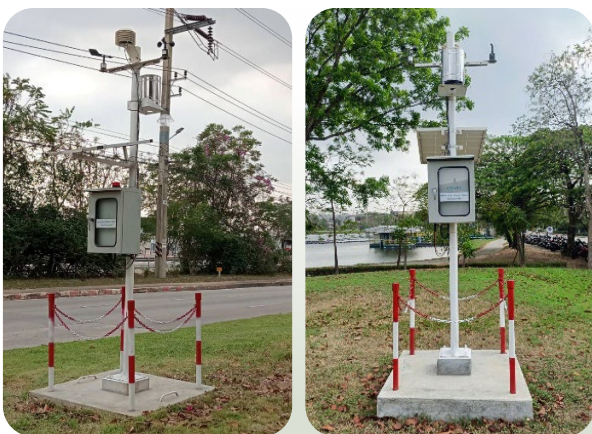
สถานีอุตุนิยมวิทยาแบบออนไลน์ (smart weather station) ในพื้นที่นิคมอุตสาหกรรมอมตะซิตี้ ระยอง
